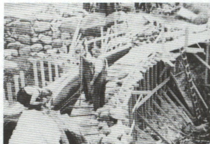
Barrage en construction. Étang des oiseaux marins. MM. Siméon Labrecque, Ovila Rhéaume (contremaître) et Hervé Boutet, 15 juin 1951
